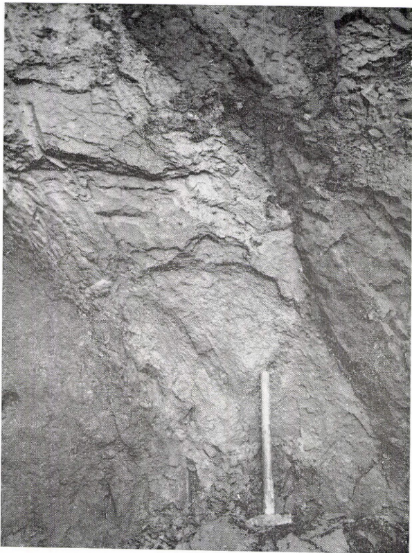
3. kép. Fakósárga lösz és vörösbagyag íves csuszamlási sík menti érintkezése
