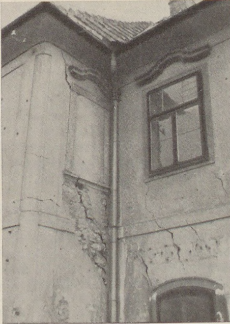
1. Részben régi falmaradványra épített főfal károsodása
