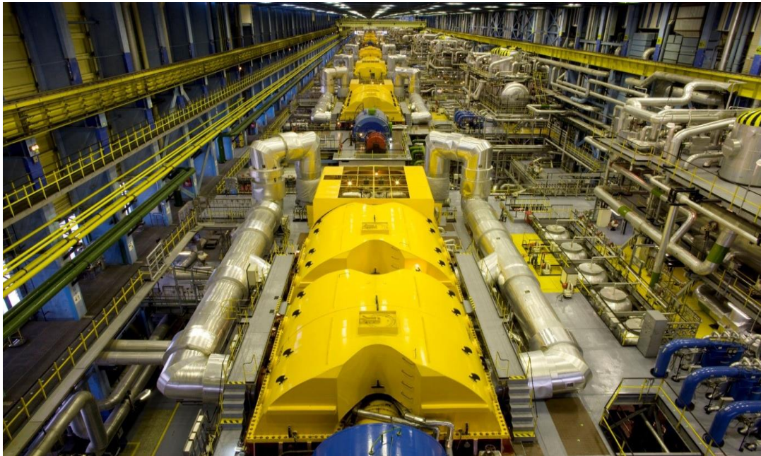
5.kép I. kiépítés turbinagépház
