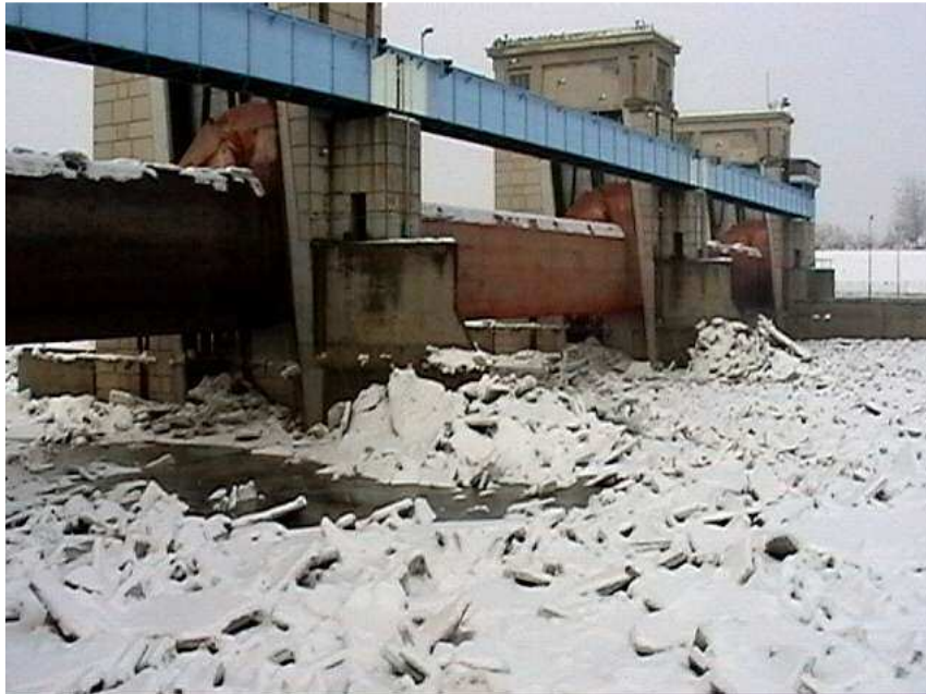
27.ábra: A befagyott erőmű
