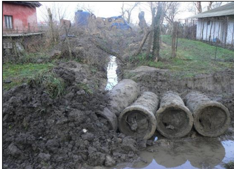
8. ábra: Szabálytalanul épített áteresz kibontása a 2010-es belvíz idején (készítette a szerző)
