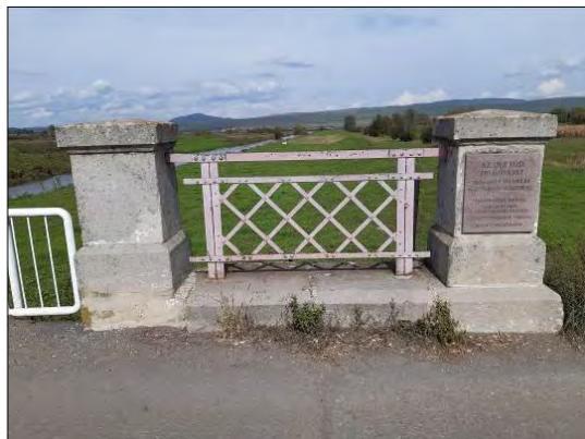
2. ábra. A régi hídfő jelenlegi állapota
