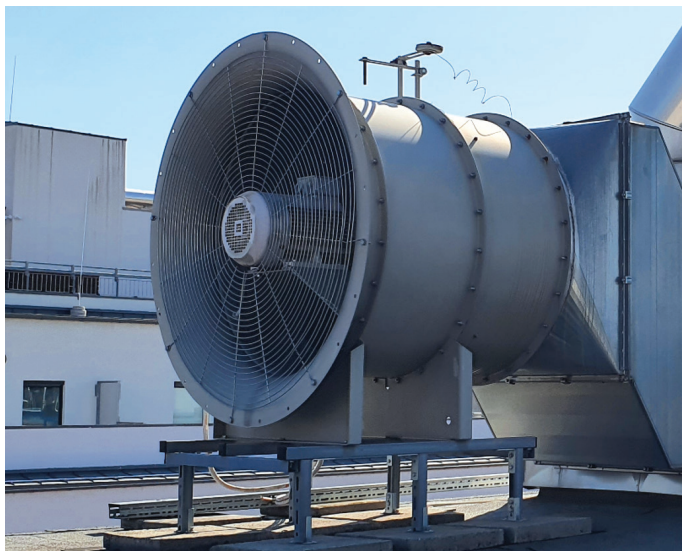
2. ábra: A lépcsőház füstmentesítő ventilátora a zárófödemen
