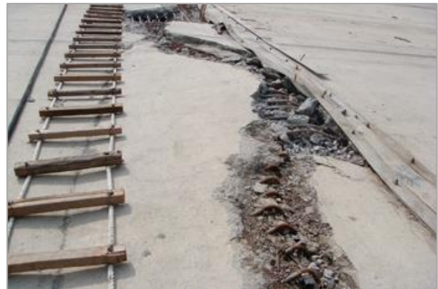
15. ábra. Vízoldali beton burkolat károsodása (IWPDC) Figure 15. Damaged concrete cover on the upstream surface (IWPDC)
