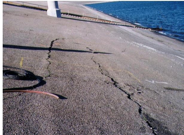
11. ábra. Repedések a Los Angeles gát felvízi oldalának burkolatán, a gát egésze sértetlen maradt (Page és társai 1995) Figure 11. Cracks on the surface pavement of the upstream slope of the Los Angeles dam (Page et al. 1995)
