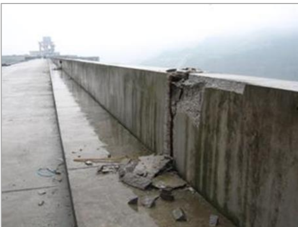
14. ábra. A vízoldali koronaélben lévő vasbeton fal károsodása (Lekkas 2008) Figure 14. Reinforced concrete wall on the upstream crest of the dam (Lekkas 2008)
