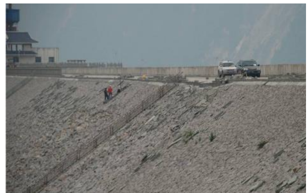
16. ábra. Mentett oldali rézsű károsodása (Lekkas 2008) Figure 16. Damage of the downstream slope (Lekkas 2008)
