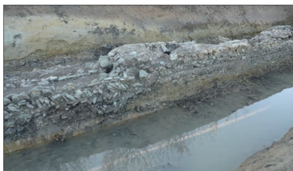
11. ábra. A vízvezeték külső oldalnézetben, bal oldalt a javított szakasz
