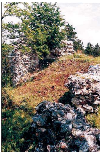
7. ábra Az északi épületrész területének a növényzet letisztítása után Area of the north building after removal of the shrub
