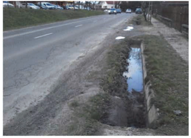
7. Ábra. Pangó víz a csapadékvíz-elvezető rendszerben
