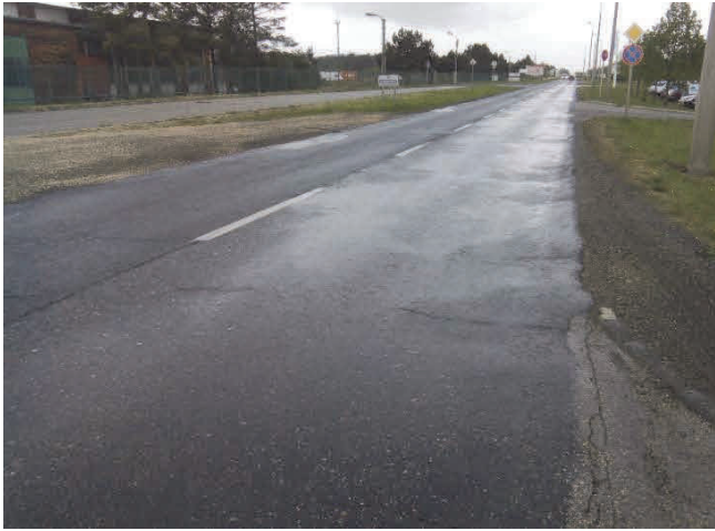
6. Ábra. Süppedés és keresztirányú repedés a burkolaton
