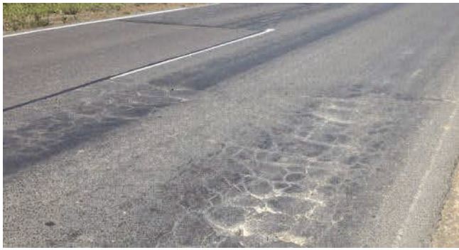
5. Ábra. A mozaikos repedés
