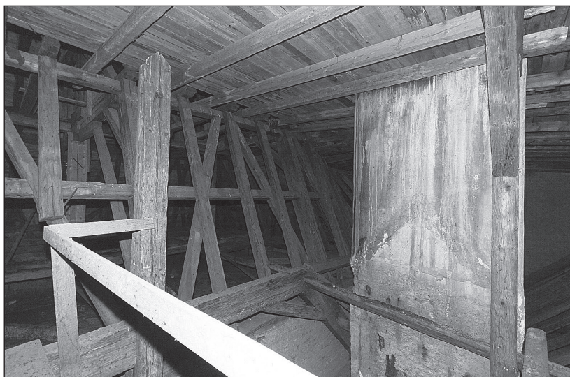
A funkció nélkül maradt függesztőoszlop és kémény a barokk fióktető lenyomatával. (Fotó: Hack Róbert)
