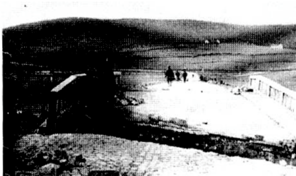
12. ábra. A károsodott híd, az út tengelyében.
