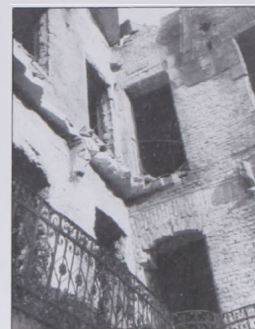
Az Állattár Baross utcai épületének 2-3. emelete a tűzvész után
