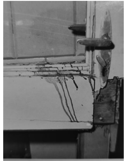
7. kép: A megrongálódott bejárati ajtó. BFL XXV. 4. a. 1957. év. 1990/II. 520. doboz, 462.
