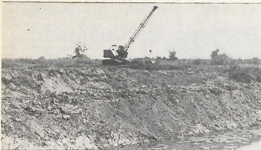
Telelőrendszer felújítása a Hortobágyon
