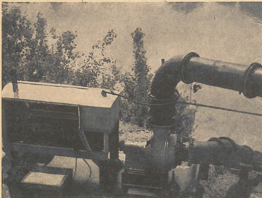
1. Hordozható DTO gépcsoportú szivattyúállás
