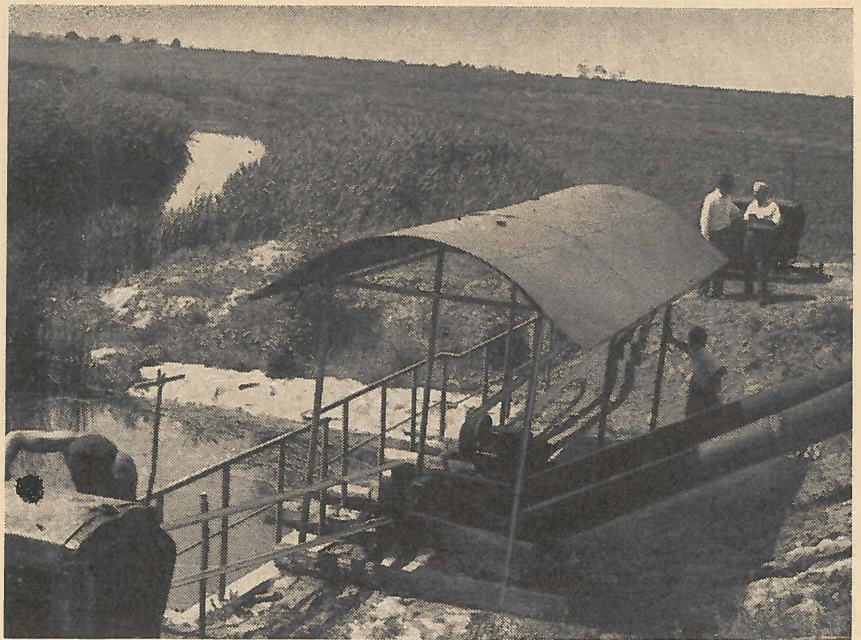
Szivattyúállás RPT szivattyúkkal
