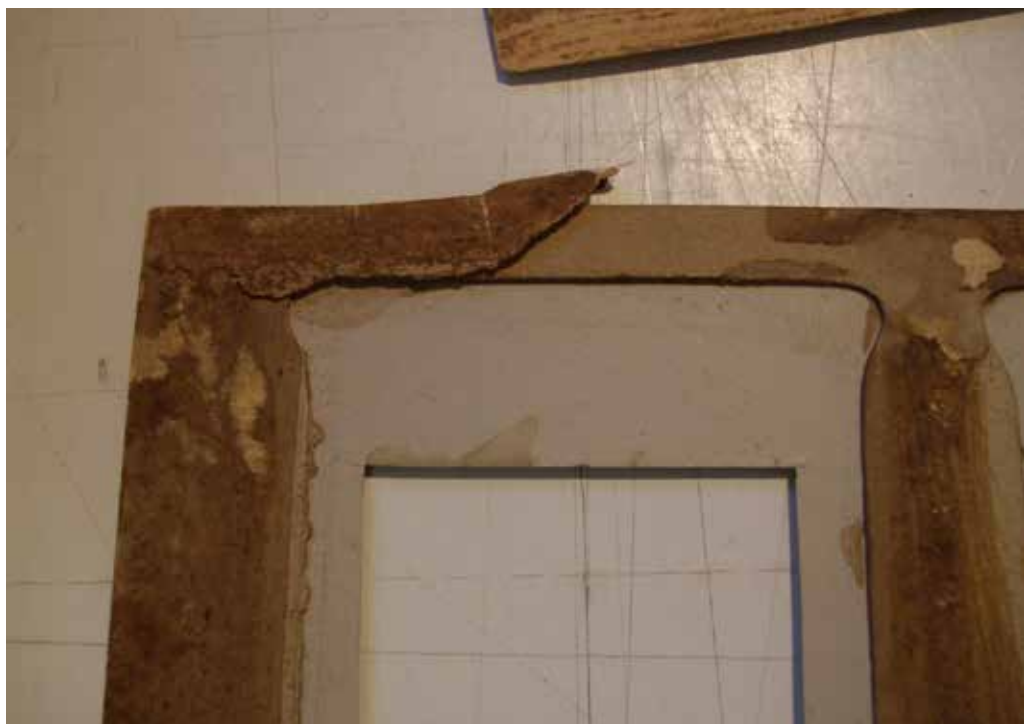
27. Szakadt, hiányos távtartó
