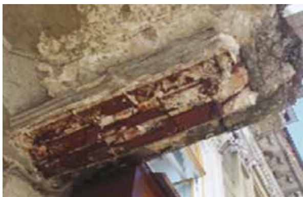
3. ábra Acélbetét korróziós termékei által lefedett fedőréteg nélküli erkélykonzol
