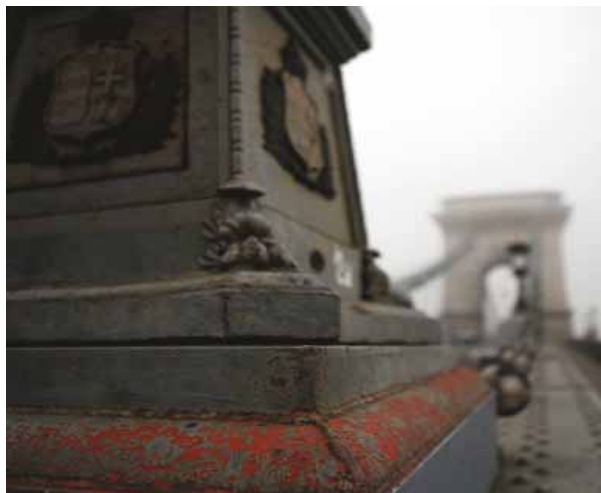
1. Festett öntöttvas és acél szerkezet korrodálódott felülete városi környezetben
