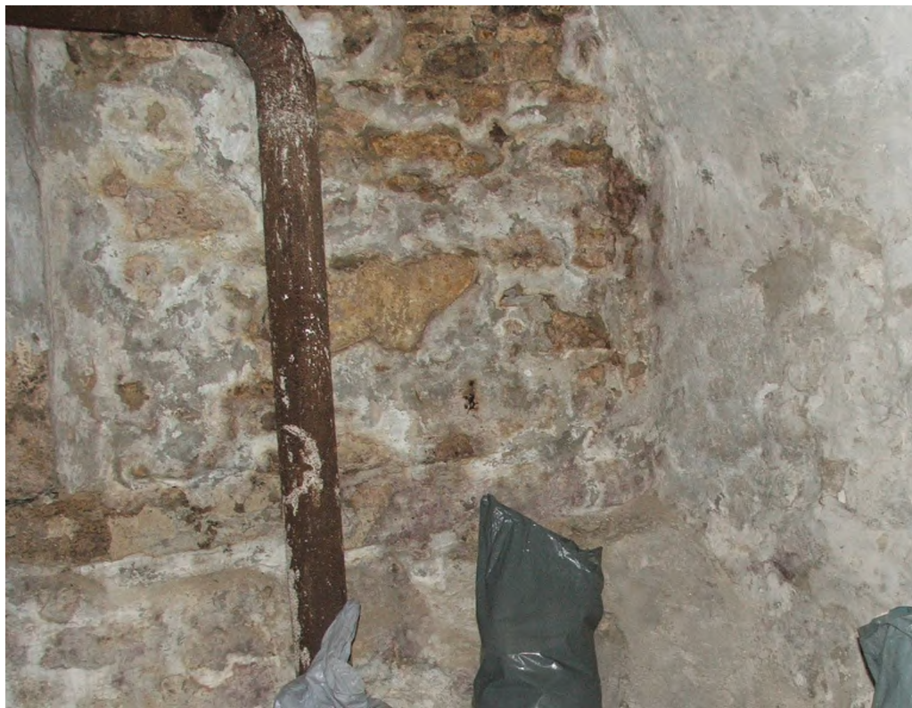
11. A ház pincéjében lévő korrodált légbeszívó cső (balról) és kémény (jobbról) (A Szerző felvétele 2006. 05. 17-én.)
