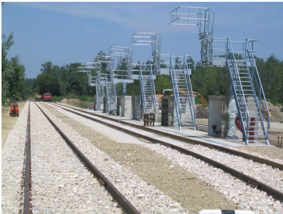
12. ábra: Korszerű vasúti üzemanyag lefejtő rendszer a kecskeméti repülőtéren 18
