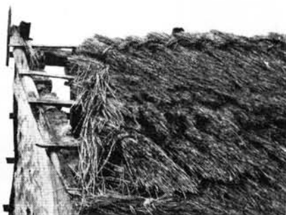
9. ábra. A fedélfák facsapos rögzítése, a zsúptető szegése és a kettős zsúpgicák. Dobai oldal 260. számú Búzás-féle pincéje.
