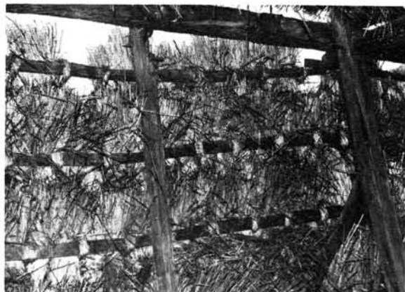
10. ábra. A gicák felkötése a tetőlécekre, az ollószáras facsapos rögzítése. Dobai oldal 260. számú, Búzás-féle pincéje belülről.
