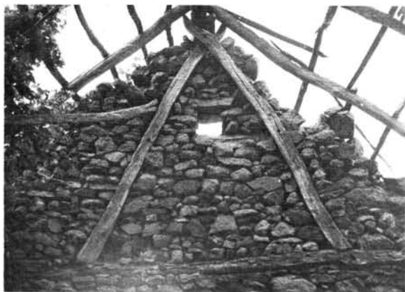
7. ábra. Kőfalú, kőoromfalú öreg, elhagyott pince, ollószáras szelemene és tetőszerkezete belülről. Kakasülő a kőfalban. Szöllősi oldal.
