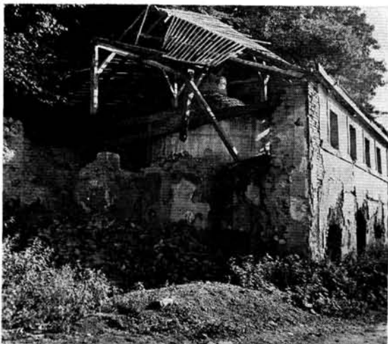
D) Az „A”/IV. sz. romos épületben lévő kemence. D) Brennofen im kriegsbeschädigten Bau „A”/IV. D) Four dans le bâtiment en ruines «A»/IV. D) Печь в руинах здания «A»/IV.
