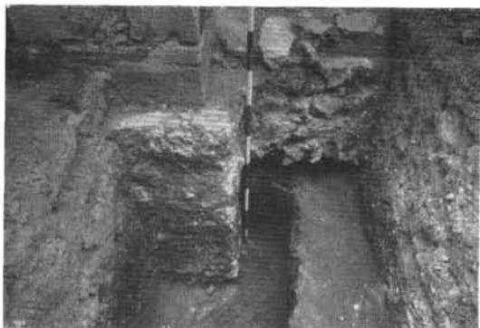
13. A hajó és a támpillér alapozása. 13. Grundbau des Schiffes und Stützpfilers. 13. Les fondaments de la nef et du contrefort. 13. Фундамент нефа и опорного столба.
