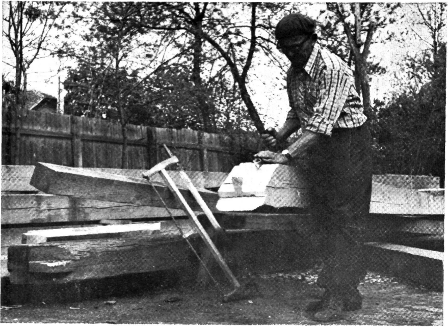
17. kép: Új szarufa csapjának készítése Figure 17: Preparation of a new blade pin
