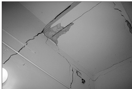
Repedések a csillagvizsgáló épületében
