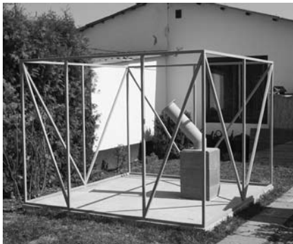
A vázszerkezet és a távcsőoszlop betontömbje. Figyeljük meg a tömbön levő döntött távcsőoszlopot!
