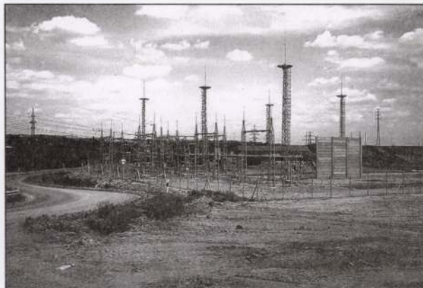
6. kép DTR fogadóportál kapcsolóállomás
