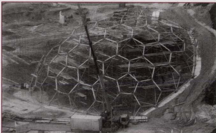
1. ábra. „Biom” építés közben. Az acélcsőkből álló vázat a felfekvési pontokon 84 kg és 111 kg tömegű GJS-400-18 és GJS-500-7 jelű gömbgrafitos öntöttvas csomópontok hordják (Építésszek: Nicholas Grimshaw és Társa)
