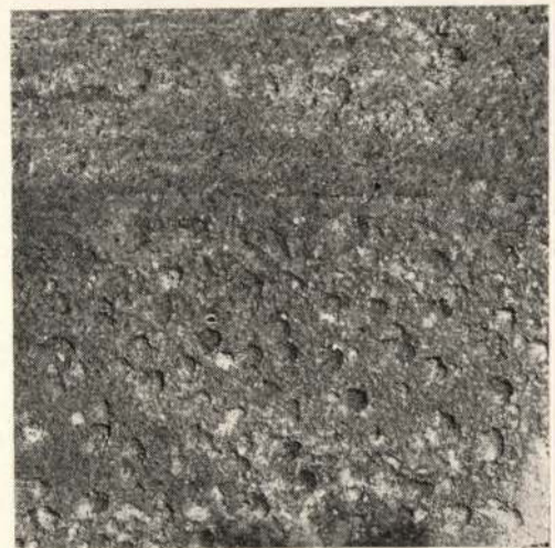
3. ábra A tartályok tetőszerkezetén és felső részén egyenetlen, vastag korróziós réteg látható
