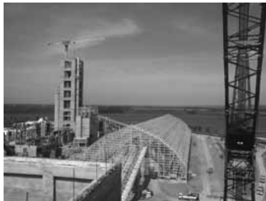
1. kép Févrácsos nyersanyag-tároló, balra a hőcserélő torony
