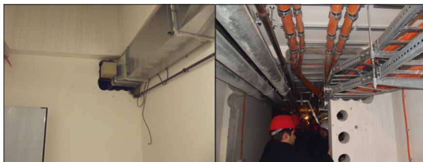
2. ábra. Budapest, M4 metró, Móricz Zsigmond körteméri állomás kivitelezési problémája és annak orvoslása
