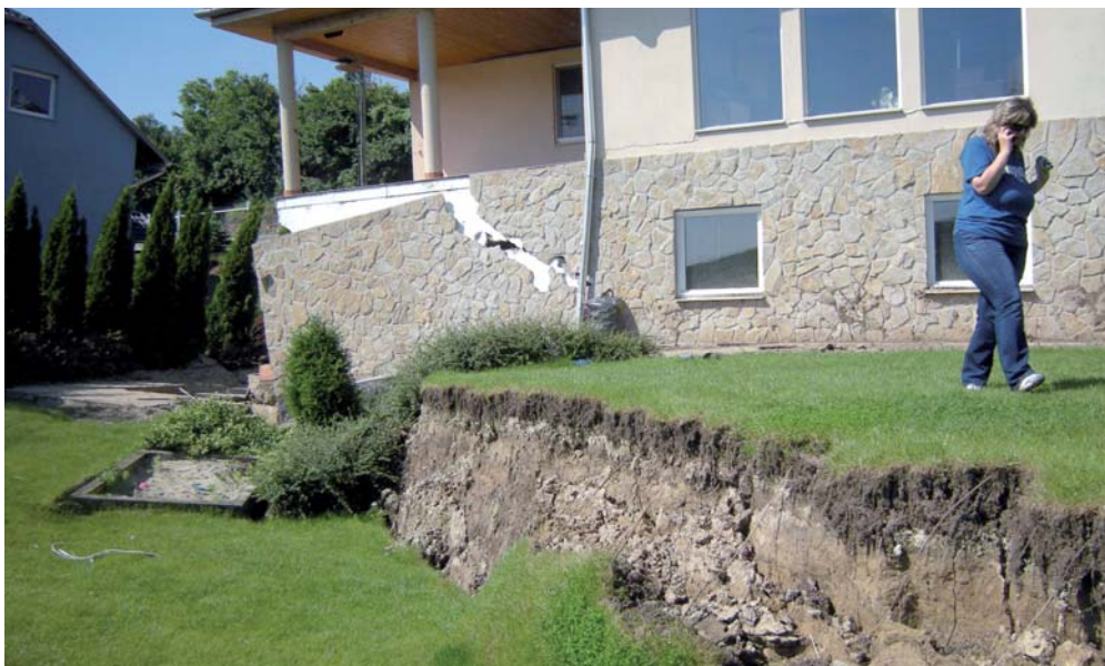
Százhalombattai völgyfőben épült házban keletkezett épületkár, 2010. június 8.
