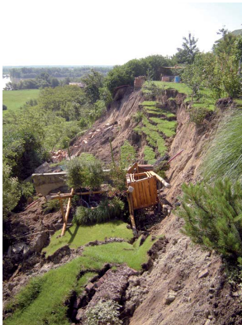
Százhalombattai völgyfőben épült házban keletkezett épületkár, 2010. június 8.
