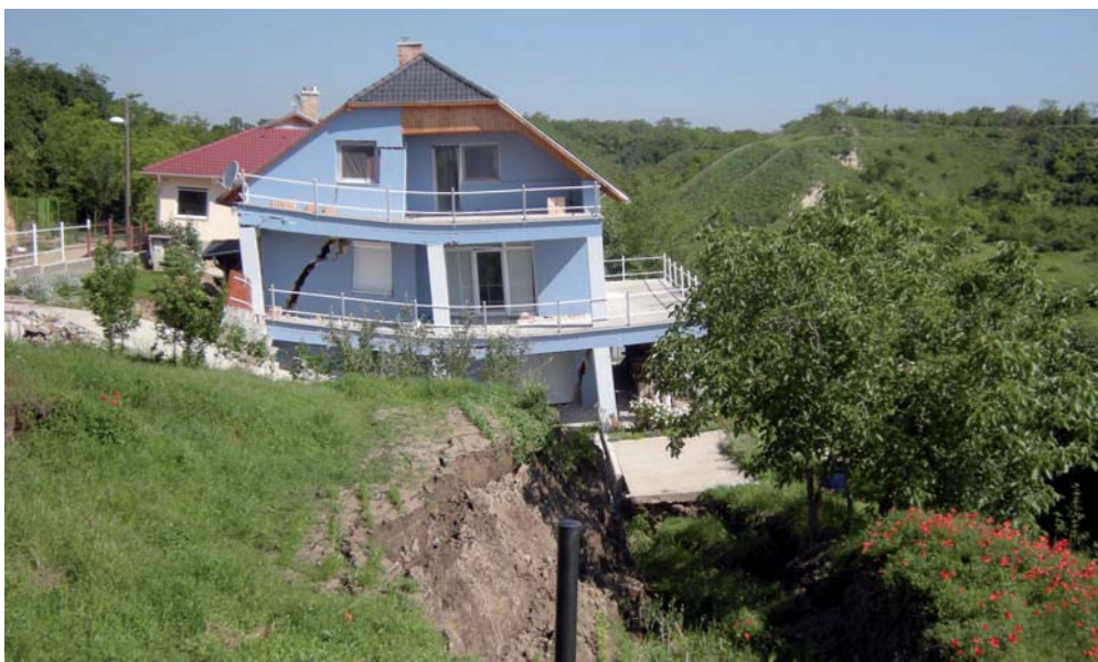
Százhalombattai völgyfőben épült házban keletkezett épületkár, 2010. június 8.
