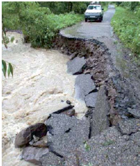
Az infrastruktúrát ért károk a Pilisi Parkerdő Zrt. területén
