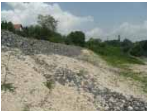
A rendkívüli esőzések jelentős kárt okoztak a 29. számú észak-balatoni vasútvonalon Csajág és Balatonkenese között
