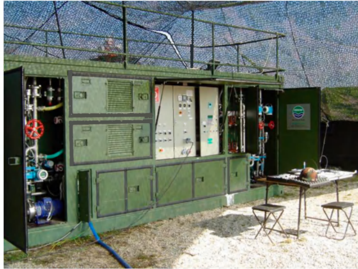
6. ábra 8 : ADROWPU berendezés
