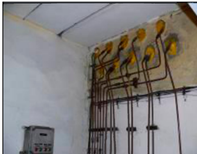
3. sz. kép: Hermetikus, tömszelencés kábelátvezetés 5
