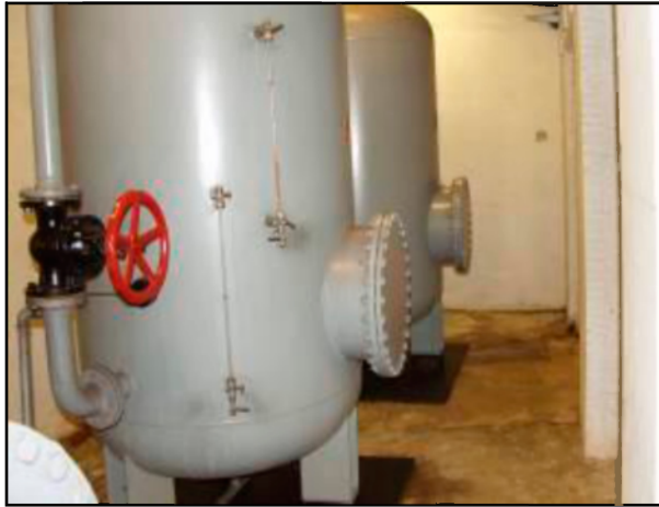
8. sz. kép: A nyomásfokozó berendezés gépháza 10
