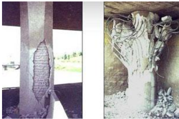
11. ábra Elégtelen vasalás miatt tönkrement vasbeton oszlopok [4]
