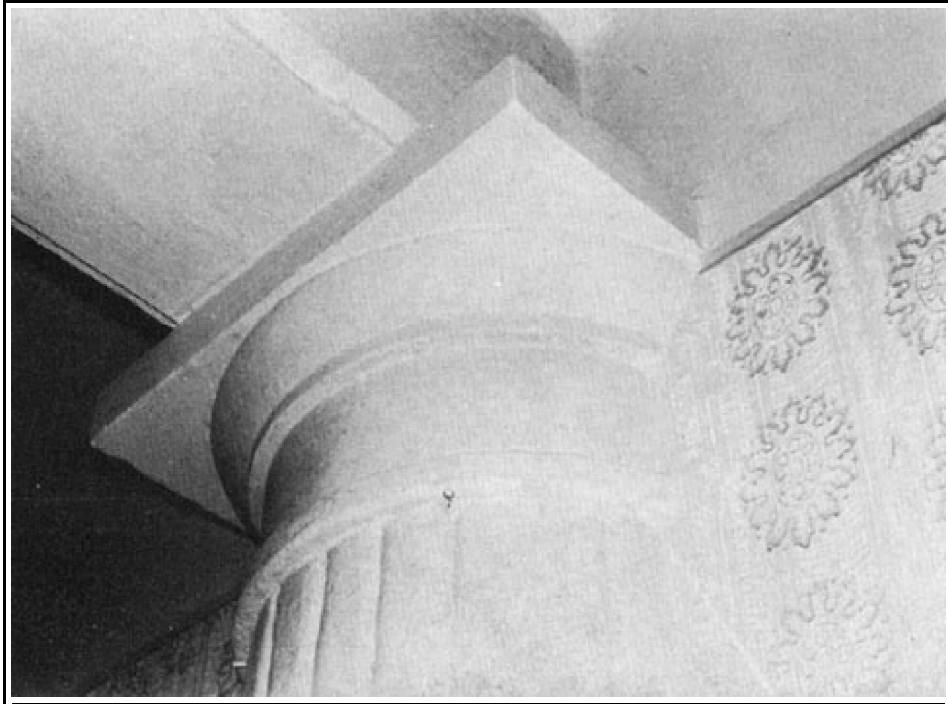
6. Rozália út 3: Elfalazott oszlop a nyugati homlokzaton a hajdani földszinti előcsarnokban (Persa András felvétele)
