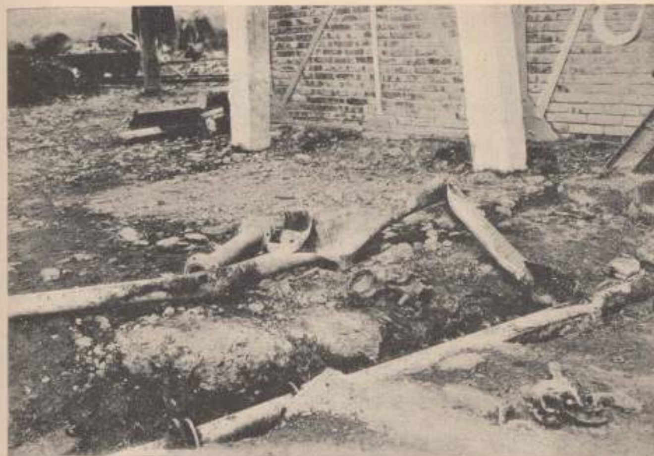
9. kép. A szétrepedt légesővezetékek.
