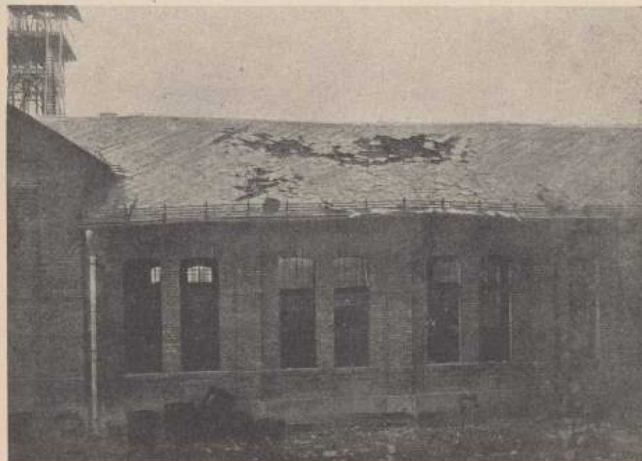
10. kép. A kompresszor-gépháznak a légnyomás által megrongált fedele.
