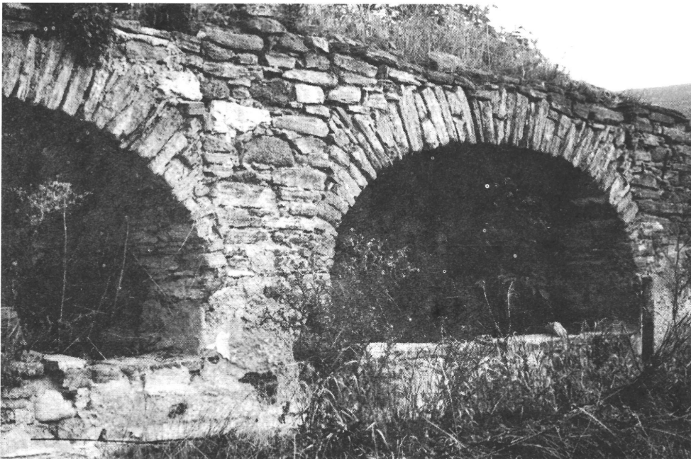
12. kép. Balatonhenyei egykori cselédház kő dongaboltozatos, íves tornácának romjai. H. Csukás Györgyi felvétele 1983. (SZNM MNÉA-N 41 422)
