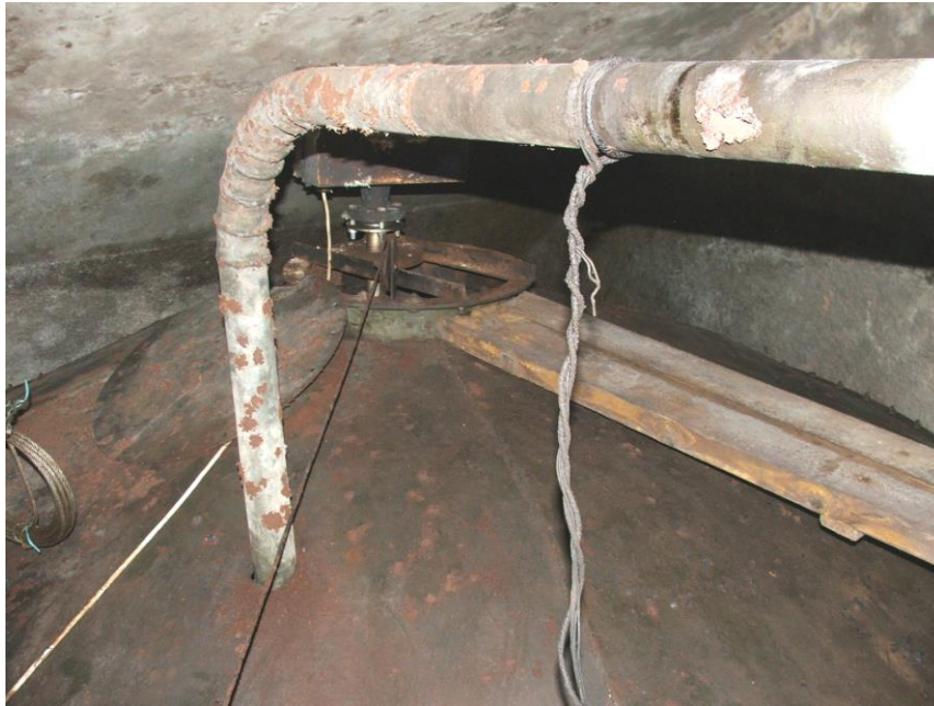
10. ábra: Nagyméretű acél üzemanyag tároló a KAGRA védett létesítményben 43
