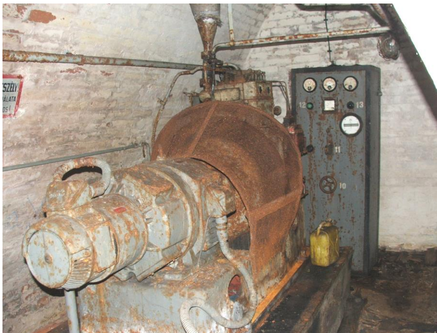
11. ábra: A budai várban az MTA épületegyüttes alatti, volt I. kerületi Polgári Védelmi vezetési pont üzemképtelen aggregátora napjainkban 44
