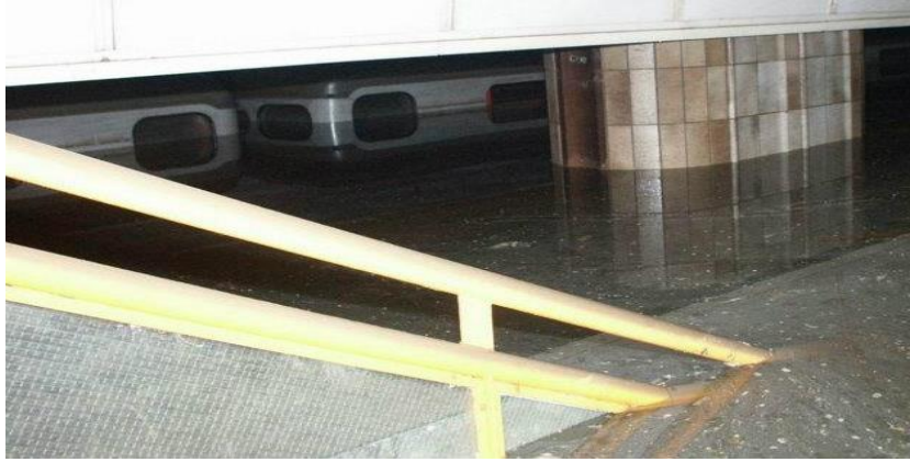
3. ábra. A prágai metró a 2002-es árvíz után
