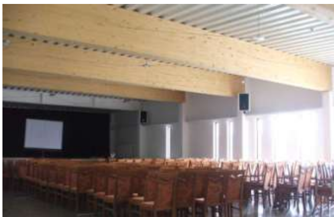
2. ábra. Közösségi épület tetőfödéme, alulnézetben. Vasbeton pillérek, látszó rétegelt-ragasztott fa főtartók, magashullámú acél trapézlemez tetőfödém
