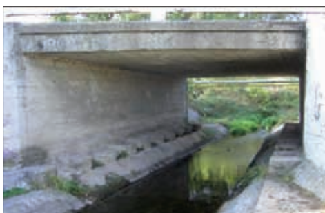
67. ábra: Mindkét oldalon betonozott híd alatti padka
