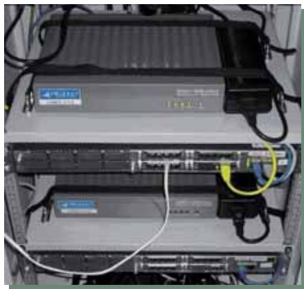
6. ÁBRA DIRECT BELTÉRI EGYSÉG ÉS CISCO 2811 ROUTER (FORRÁS: MH VITÉZ SZURMAY SÁNDOR BUDAPEST HELYŐRSÉG DANDÁR MH HÍRADÓ ÉS INFORMATIKAI RENDSZERFŐKÖZPONT VEZÉTSÉBIZTOSÍTÓ ÉS TÁMOGATÓ ÁLKÖZPONT [MH VBTA] ARCHÍVUMA)
