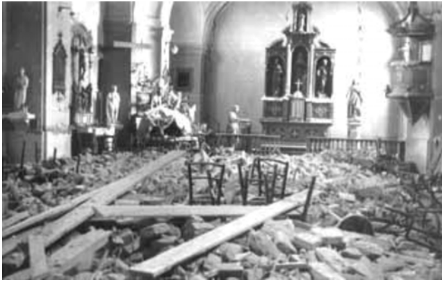
A taksonyi templombelső a földrengés után
