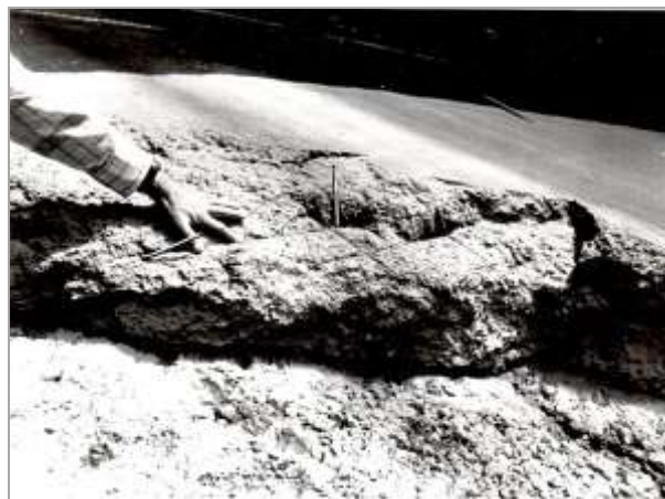
2. kép. A felszakadt kopóbeton helyszíni felvétele, melyen jól látható, hogy az alapbeton durva adalékanyaggal készült, és a kopóbeton elvált az alapbetontól
