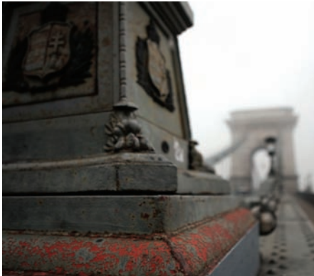
1. ábra. Festett öntöttvas és acélszerkezet korrodálódott felülete városi környezetben
